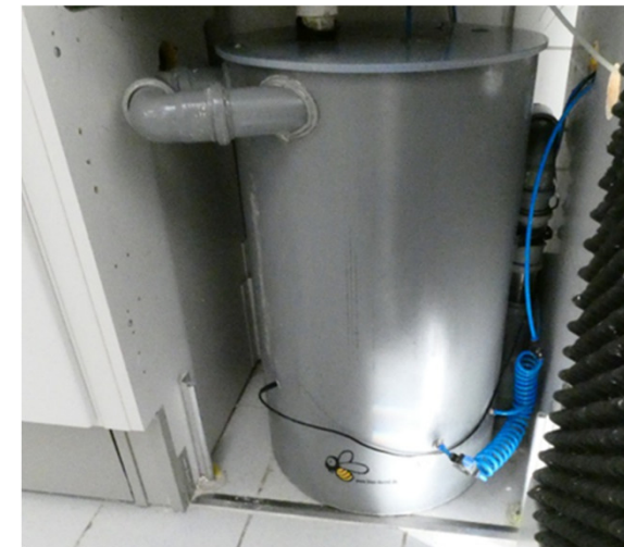
Gipsabscheider Foto: Handwerkskammer Hannover
